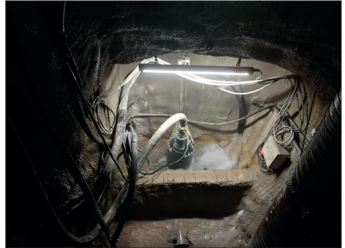
Bild 3: Pumpenkammer im Schacht
